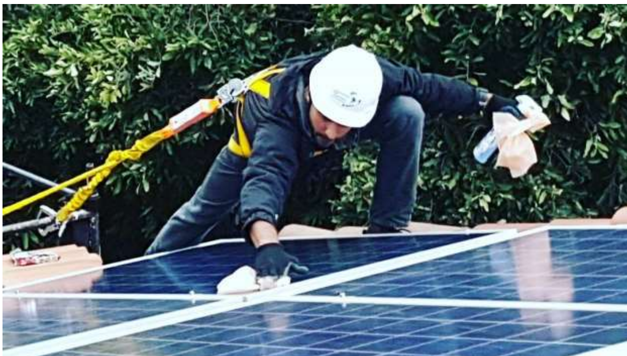
Volontari della organizzazione Ingegneri Senza Frontiere hanno donato e installato il sistema dei pannelli solari nella Casa di Accoglienza
